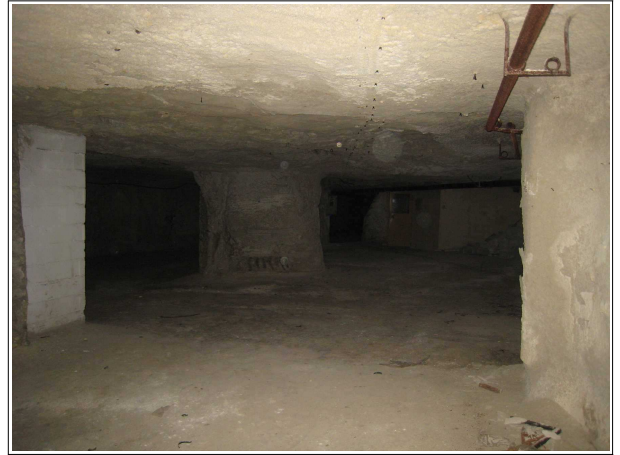
Illustration 1.9 : Chambres et galeries d'une carrière exploitée industriellement selon la méthode des chambres et piliers, Saint-Cyr-en-Bourg (49), 2012
