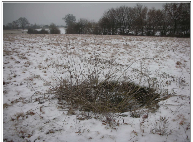
Illustration 1.14 : Tassement du remblai d'un puits d'accès à une carrière souterraine, Thoiré-sur-Dinan (72), 2009
