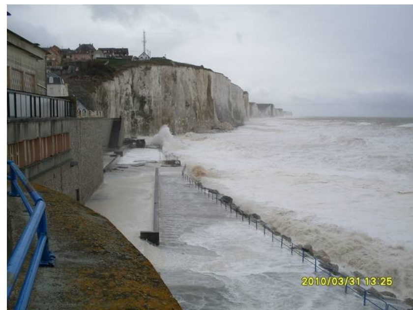
Attaque et destruction partielle du front de mer de Ault lors des tempête de 2010 (Mairie de Ault, 31.03.2010)
