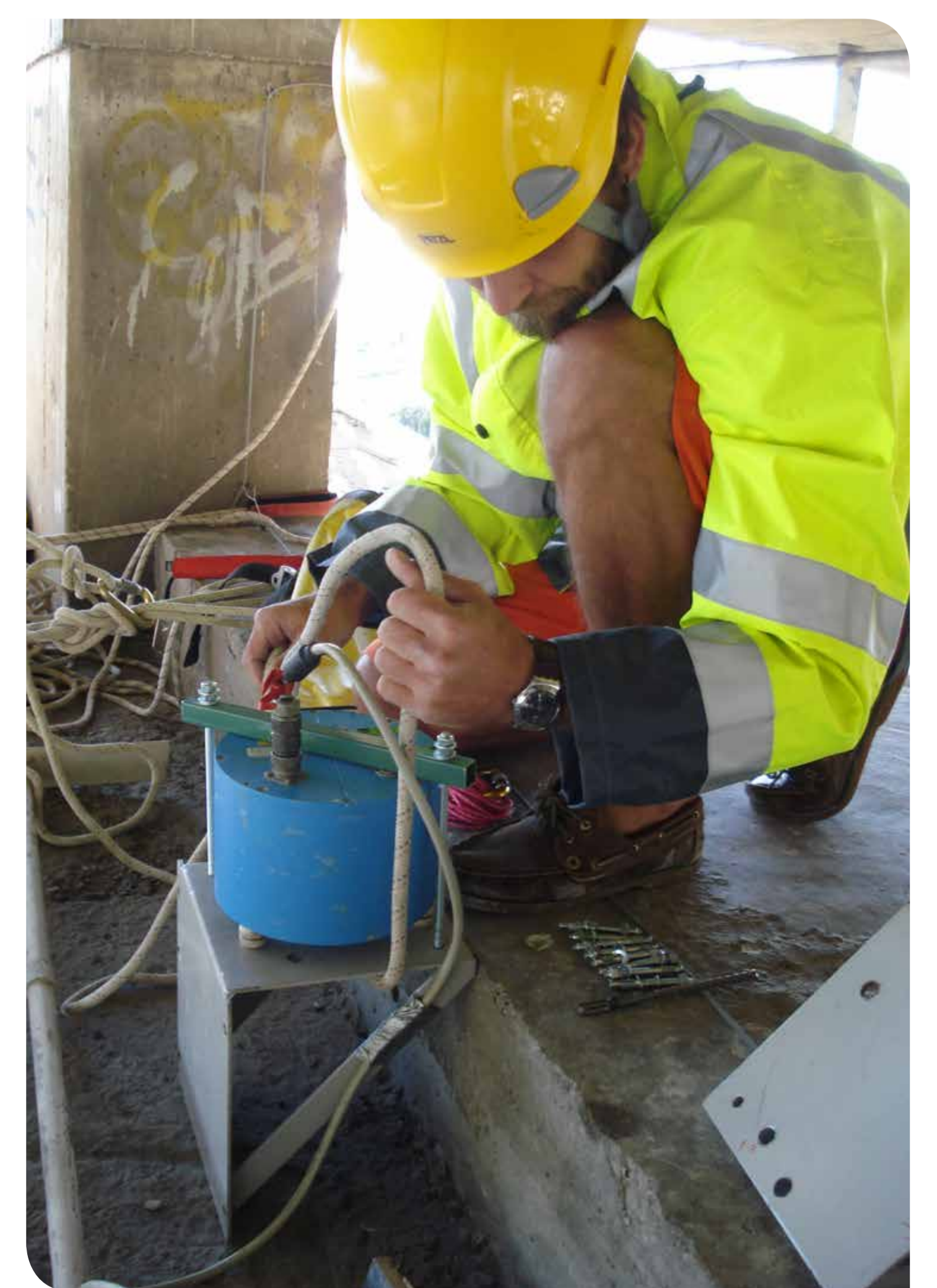
Installation d'un capteur sismologique sur le viaduc de Caronte (Martigues, 13) © Cerema
