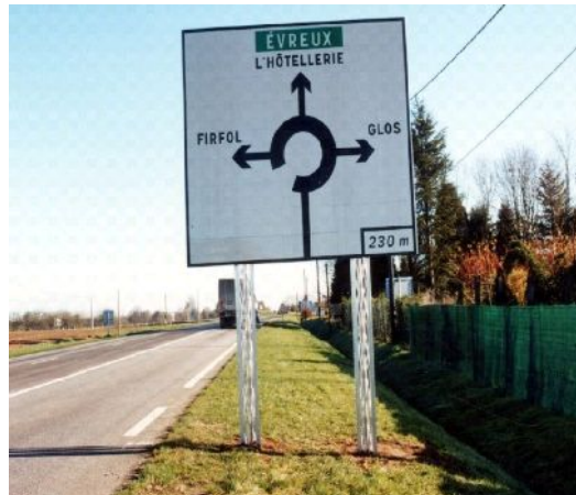
Supports de D42b fragilisés (autorisation nécessaire) Source: "Supports fragilisés d'équipements routiers", CETE NC 2007
