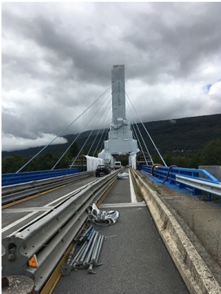
Échafaudage pour l'accès au pylône et protection vis-à-vis des usages de la RD992
