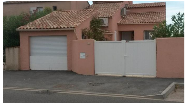
Figure 5 : Quartier La Forge - présence de batardeau suite à la crue de 2014 © Projet COPARI
