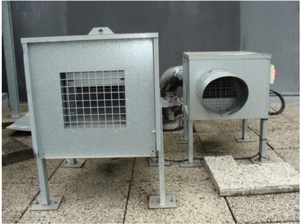
Illustration 80: Moteurs d'extraction reliés aux salles du rez-de-chaussée (gauche : salles de travaux pratiques/salles pédagogiques et droite : sanitaires centraux)
