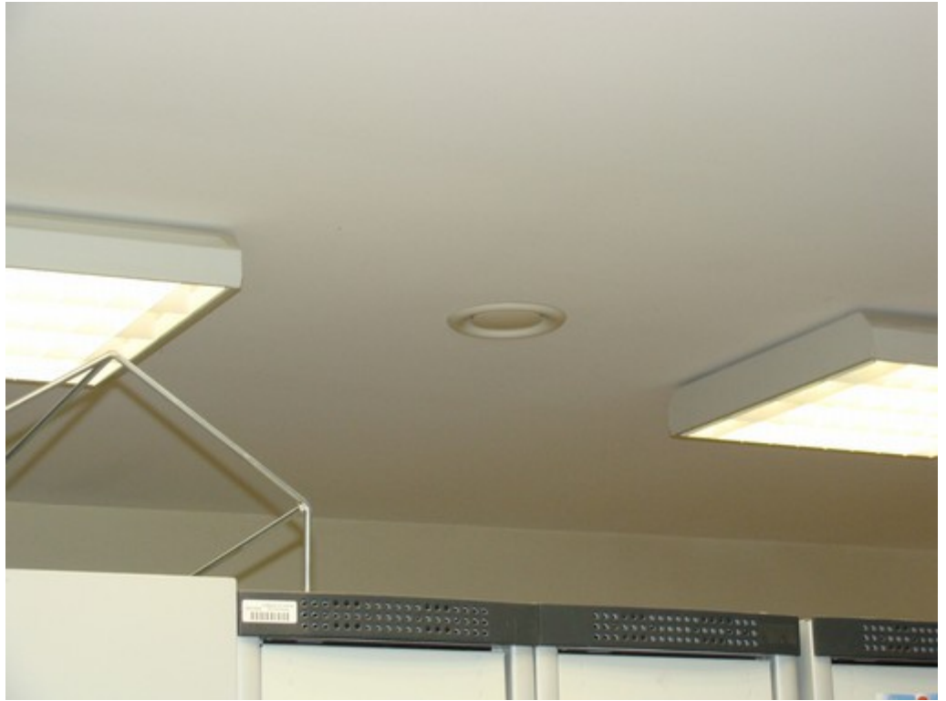
Illustration 133: Bouche de ventilation dans les vestiaires des hommes
