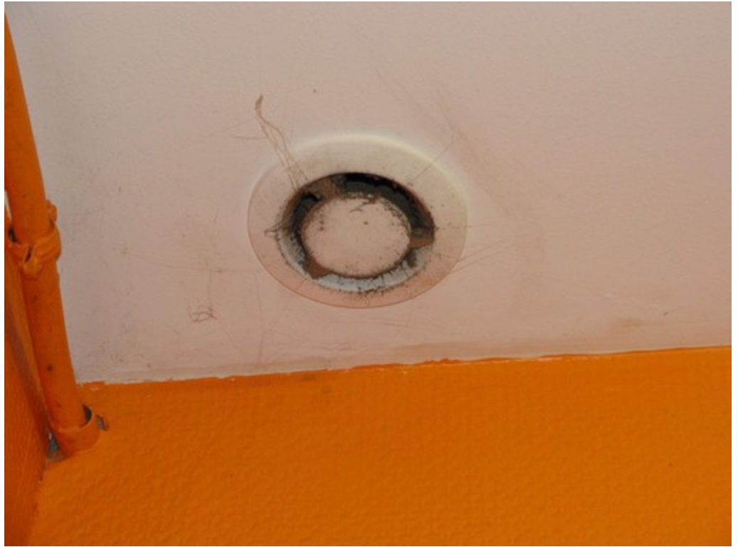
Illustration 41: Bouche de ventilation encrassée des vestiaires du bâtiment B2
