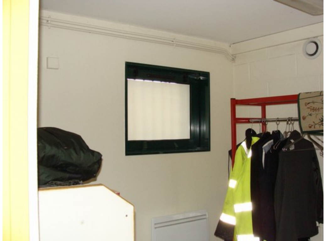
Illustration 132: Bouche de ventilation dans la pièce de séchage des hommes
