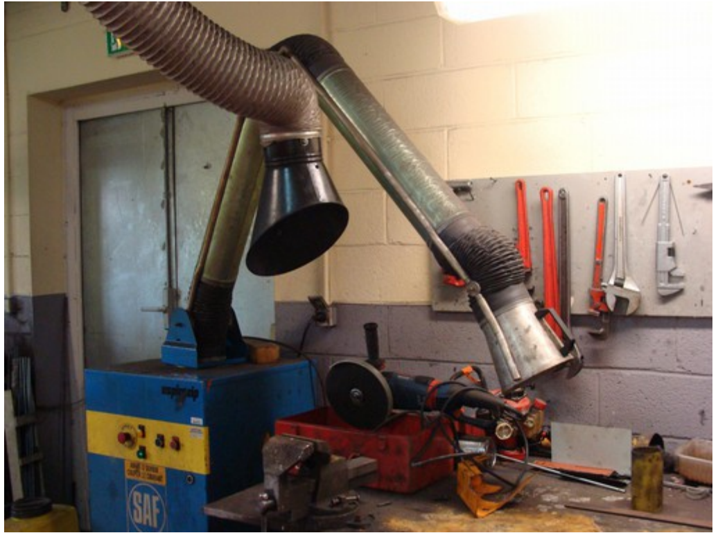
Illustration 11: Second extracteur ponctuel du poste de soudure
