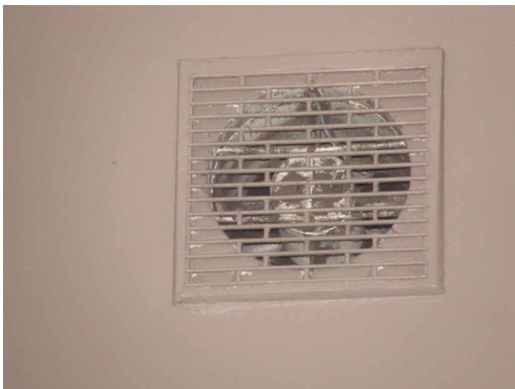
Illustration 44: Bouche de ventilation du bâtiment B5, semblant être à l'arrêt
