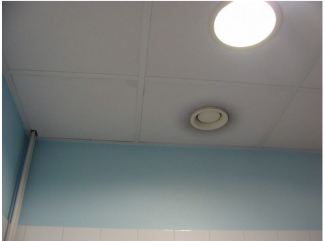
Illustration 45: Bouche d'extraction dans les sanitaires du bâtiment B6
