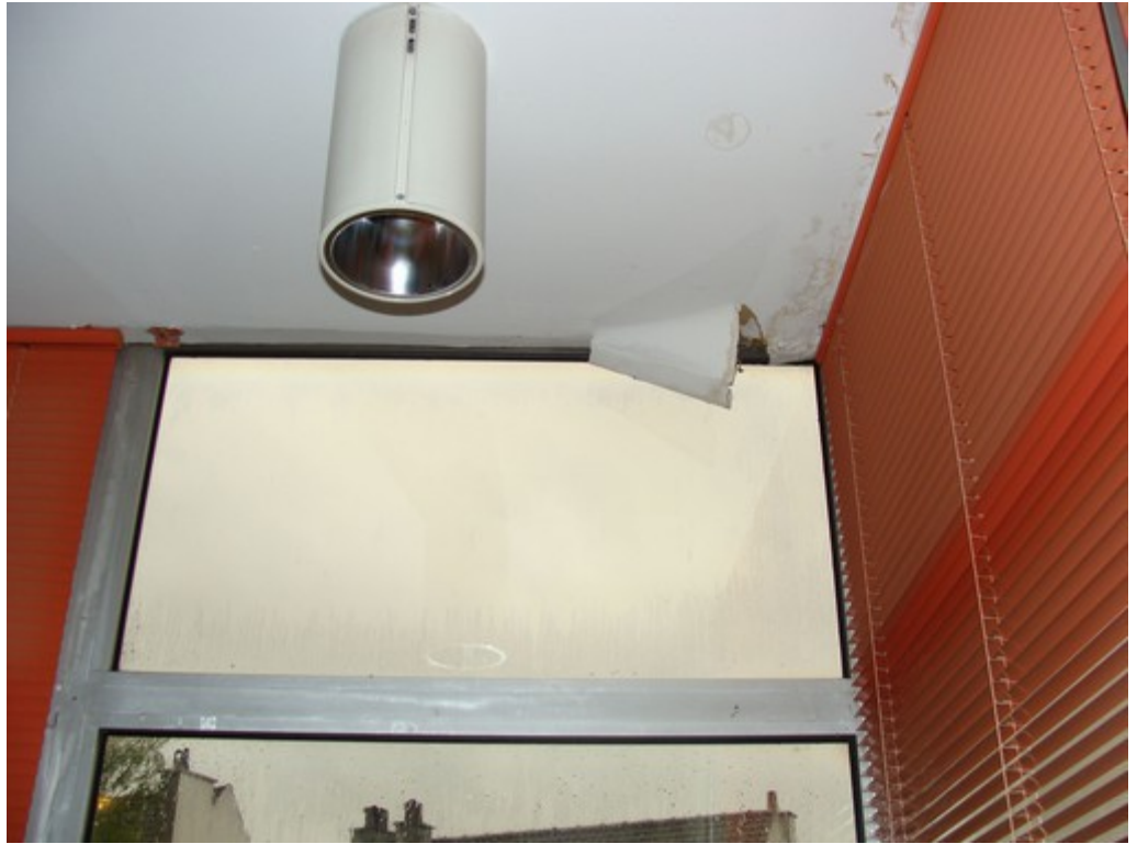
Illustration 47: Détérioration du plafond du bâtiment B7 suite à une fuite d'eau
