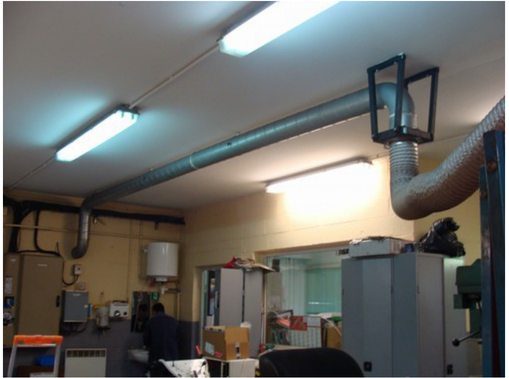
Illustration 10: Extracteur ponctuel principal du poste de soudure
