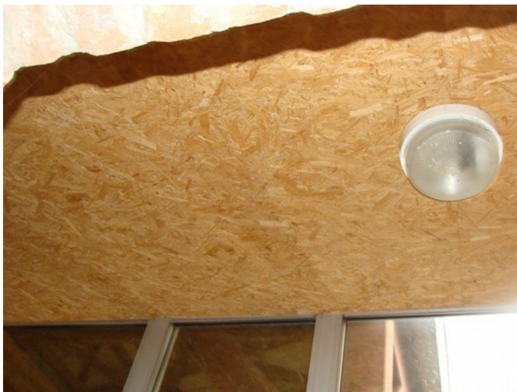
Illustration 52: Panneaux OSB en contact direct avec l'air intérieur dans le bâtiment B7
