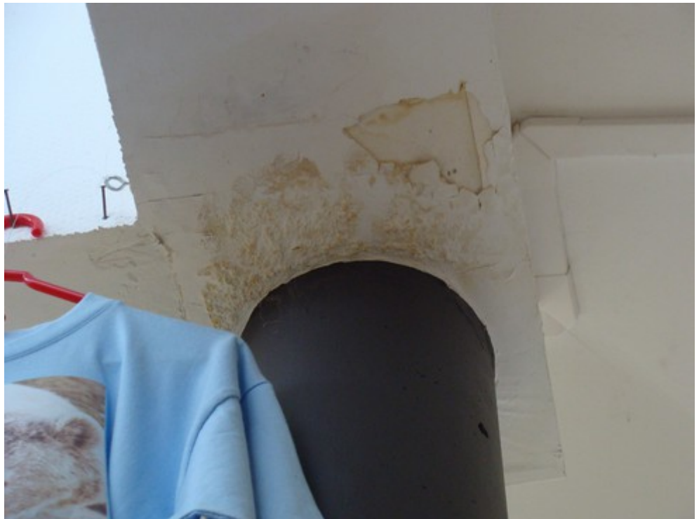
Illustration 35: Bâtiment B4, zone d'accueil, fuites au niveau des 4 poteaux intérieurs
