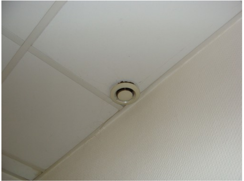
Illustration 43: Bouche d'extraction décollée dans un des sanitaires hommes du bâtiment B4
