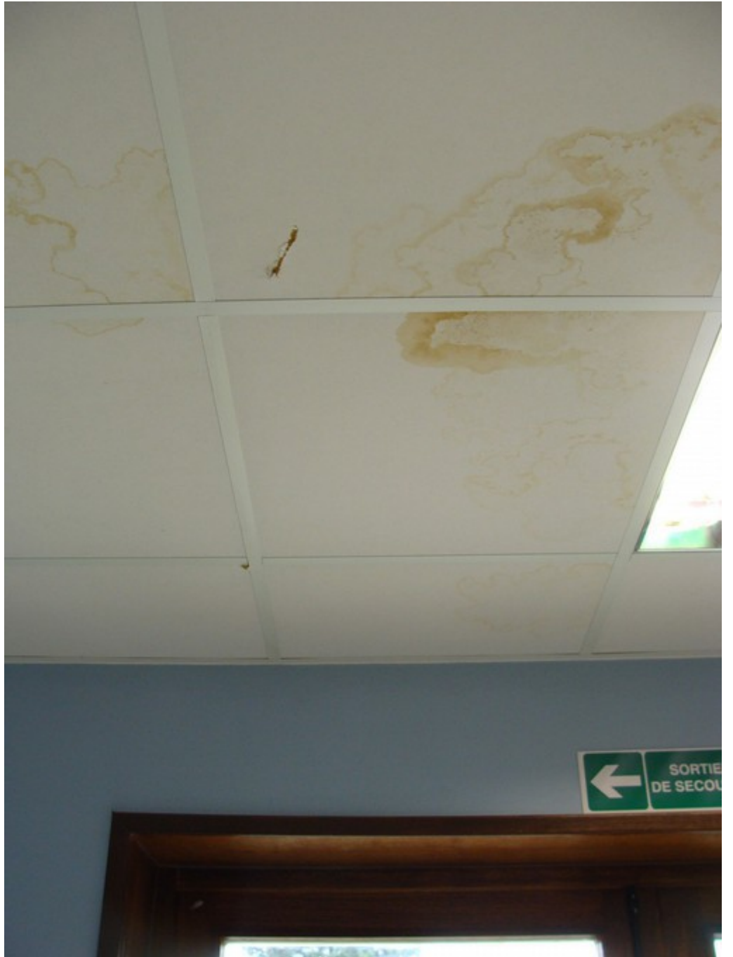
Illustration 38: Traces au plafond du bâtiment B6 issues d'une ancienne fuite d'eau
