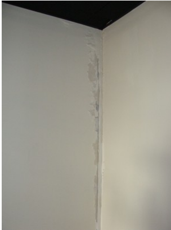
Illustration 89: Fuite dans la salle des pas perdus ayant entraîné une dégradation du mur
