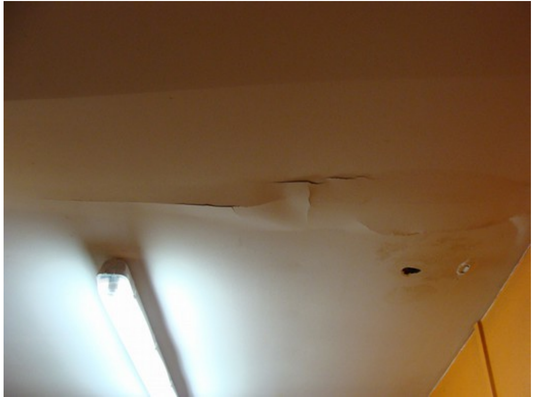
Illustration 32: Plafond du bâtiment B2 détérioré suite à une fuite d'eau
