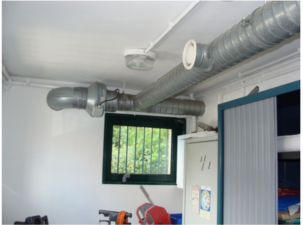
Illustration 130: Bouche d'extraction et moteur d'extraction n°2
