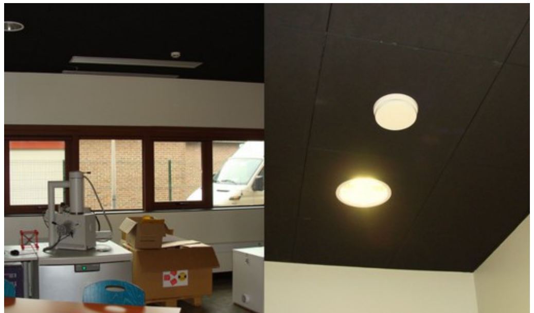
Illustration 79: Renouvellement d'air en salle de travaux pratiques (grilles des ventilo-convecteurs à gauche et bouche d'extraction à droite)
