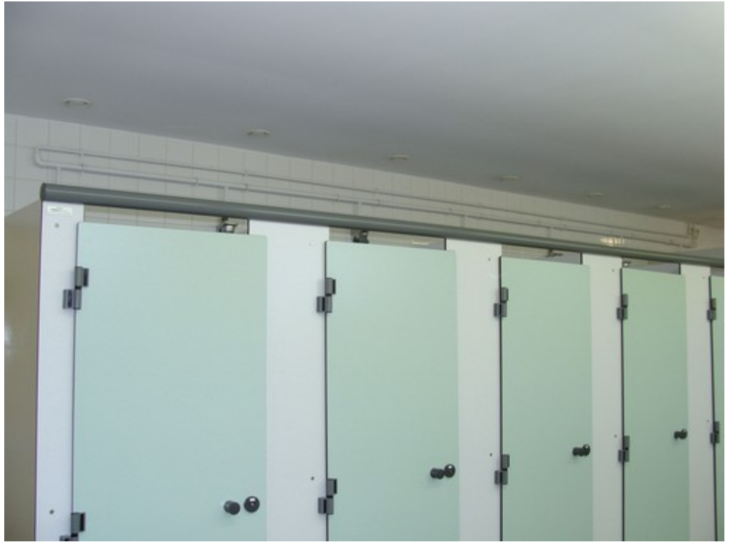
Illustration 134: Bouches de ventilation dans les douches des hommes
