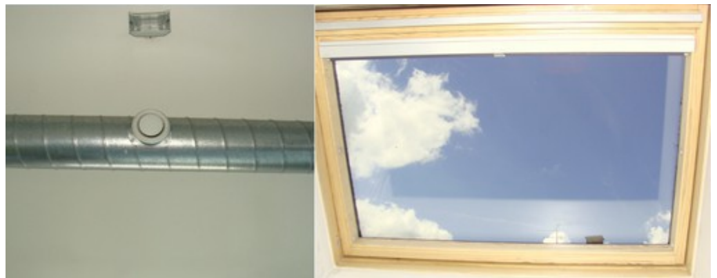
Illustration 131: Bouche de ventilation du réfectoire et fenêtre de toit pour aérer
