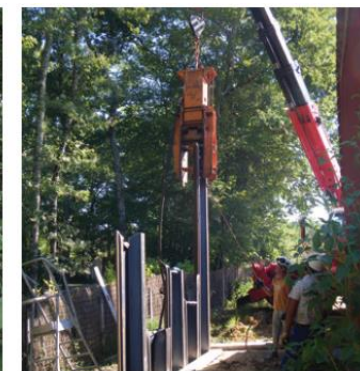
Écran métallique placé à une distance minimale de 4 m de l'arbre
