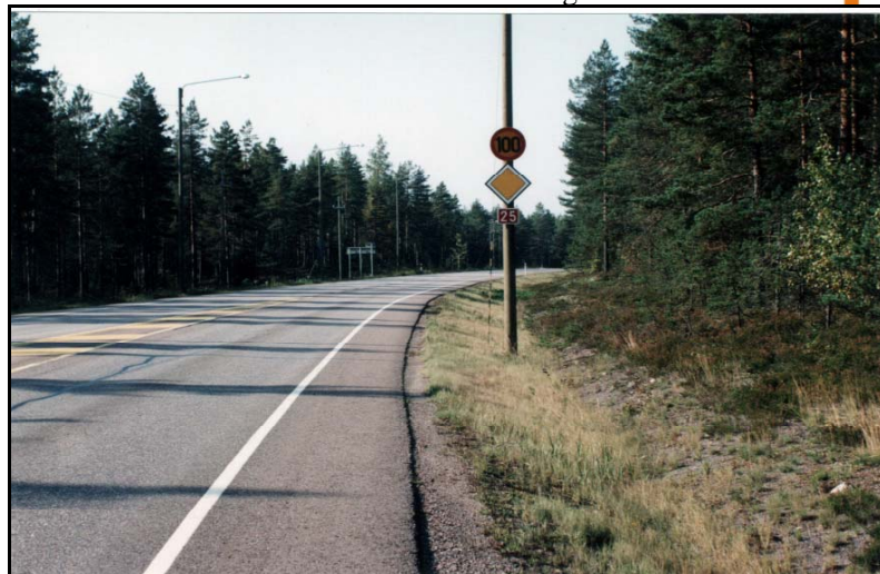
Poteau en bois fragilisé
