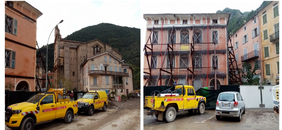
Bâtiment à proximité de l'église de Breil, condamné en raison de problème de dissolution de gypse
