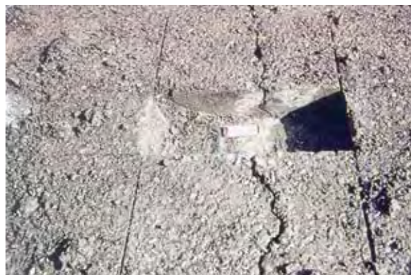
Photo 3 : fissures du CER pénétrant jusqu'à la membrane d'étanchéité – Source : LRPC d'Angers
