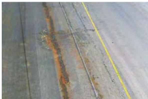
Photo 4 : corrosion de la tôle de platelage en périphérie de la DBA – Source : CETE de l'Ouest
