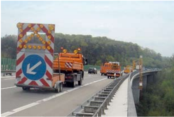
Photo 1 : nacelle de visite pour inspection, et gêne du trafic qu'il faut accepter – Source : Georg Küffner
