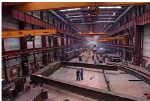
Photo 11 : contrôle géométrique par présentation en usine des éléments à blanc pour un about biais (atelier URSSA au Pays-Basque) Source : Gérard Forquet (Sétra)
