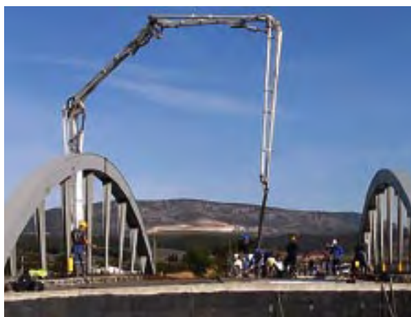
Photo 13 : bétonnage en place de la dalle sur coffrage général en bois - Source : RAZEL
