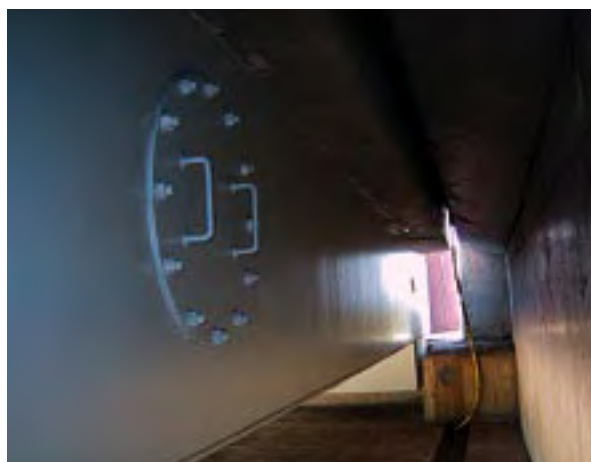
Photo 14 : espace de 700 mm à l'about de la charpente - À noter la trappe d'entrée pour la visite du caisson d'about Source : Jacques Berthelémy (Sétra)
