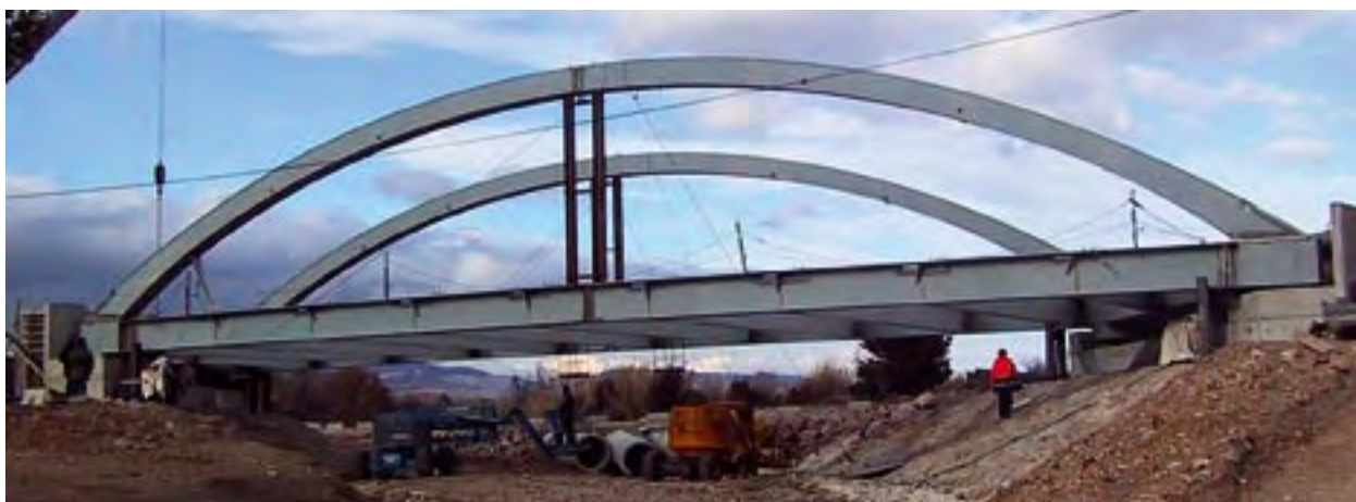
Photo 12 b : phases successives du montage de la charpente – Source : Jacques Berthelémy (Sétra)
