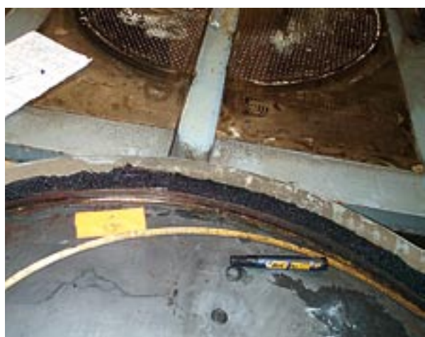
Photo 1 : vue du joint anti-extrusion, du dessus d'un coussin en élastomère et la rive de la virole avec les traces d'oxydation.
