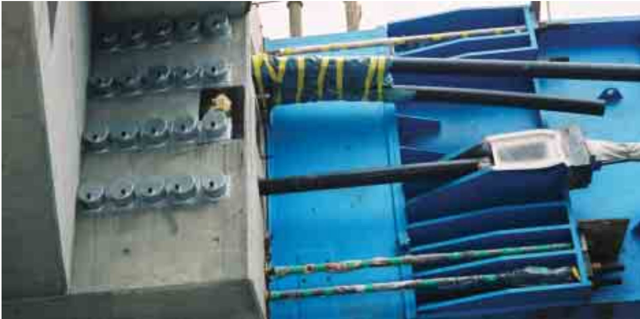
Liaison tablier avant-bec après renforcement de la pièce d'ancrage des câbles de poussage
