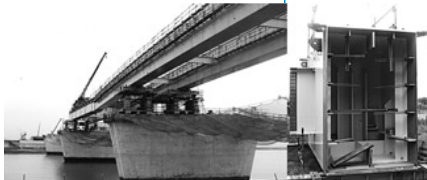
▼ Pont sur la rivière Inabe : mise en place par lançage et détail d'un caisson
