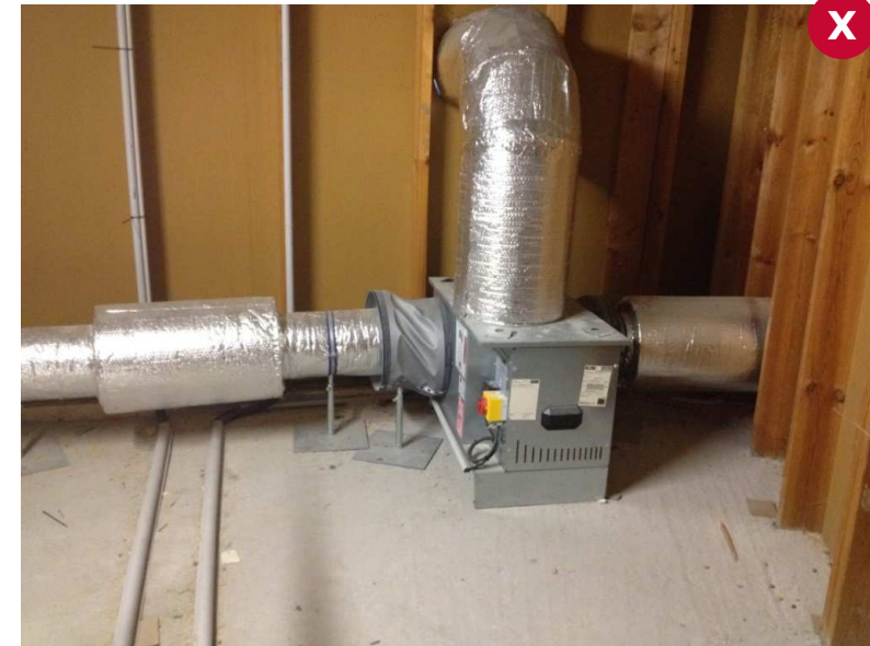
Absence de dispositifs acoustiques conformes aux Règles de l'art
