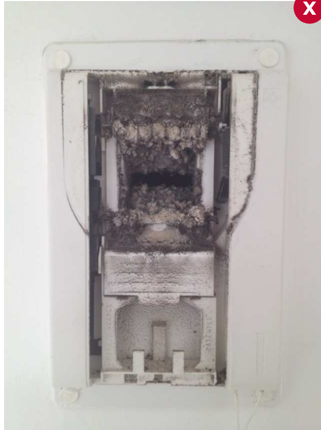
Bouche d'extraction non entretenue
