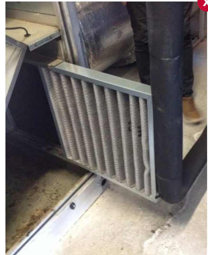
Difficultés d'entretien en raison de locaux techniques exigus et difficiles d'accès
