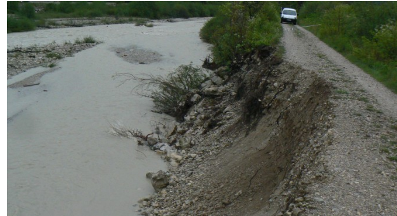
Digue des Levas la Faurie après la crue de 2013 source SMiGiBA
