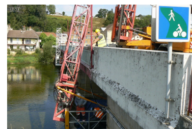
Les travaux se situent en très grande partie sous la partie basse du pont.
