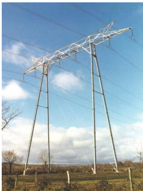
Réseau aérien HTB de 225 kV
