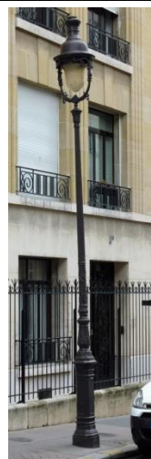
Éclairage public - Luminaire
