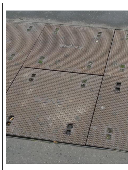
Installation électrique de gare
