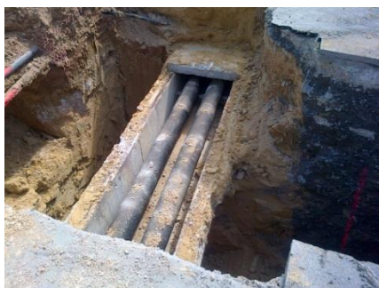
Réseau en caniveau
