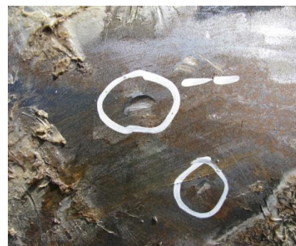
pioche / canalisation acier gaz HP
