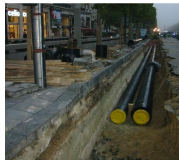
Réseau en pleine terre
