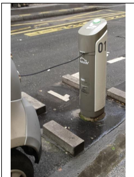
Borne de recharge électrique
