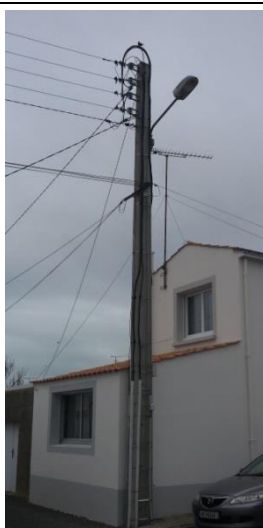
Réseau aérien BT sur support commun
