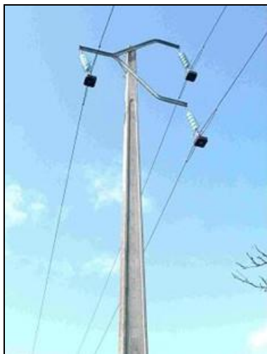
Réseau aérien HTB de 63 kV sur poteau béton
