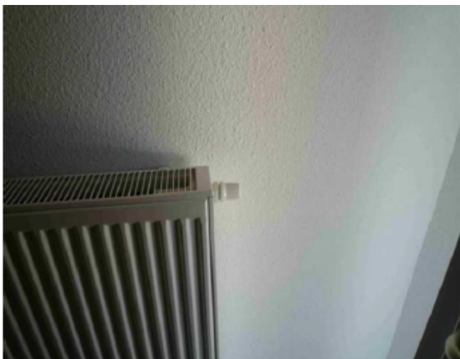
Absence de robinet thermostatique
