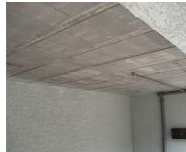
Absence d'isolant en plancher haut dans parc
