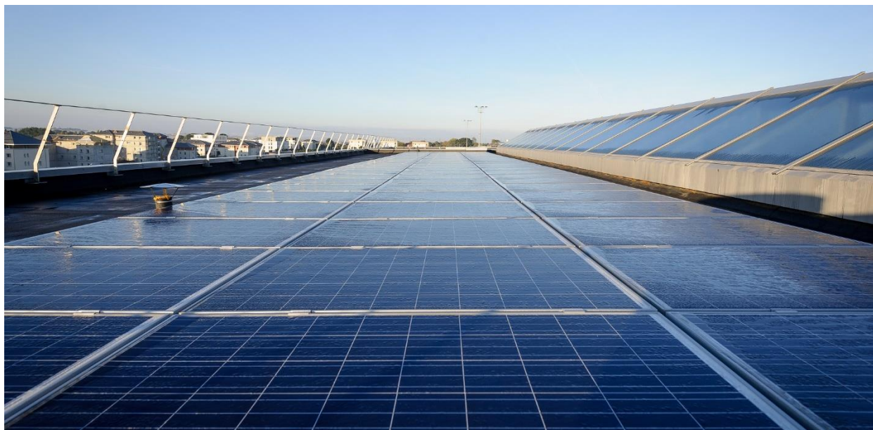
Panneaux photovoltaïques sur la toiture d'un collège – Arnaud Bouissou - TERRA
