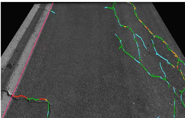
Détection des fissures et de leur gravité
