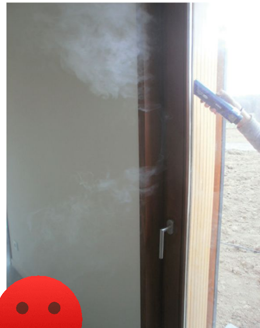
Menuiserie bois ayant travaillée à cause de l'humidité
