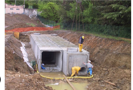
Conduite surdimensionnée Photo : Stracchi
