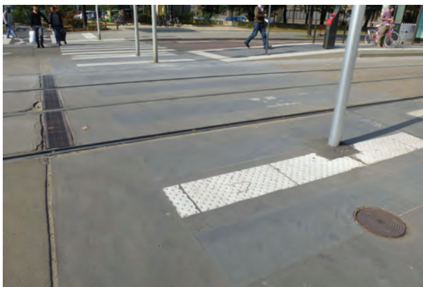
Illustration 3: Traversée piétonne avec peu de contraste entre refuge, plateforme tramway et GLO (Crédit photo : Cerema)
