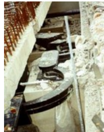
Photo 3 : Dispositifs élastoplastiques rompus après avoir subi un séisme 2x supérieur au séisme de calcul mais ayant néanmoins évité l'effondrement de l'ouvrage (Bolu Viaduct - Turquie, 1999)
