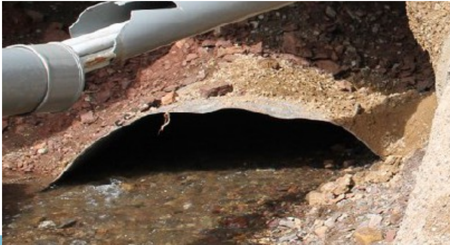
Déformation du sommet de la buse liée au tassement
