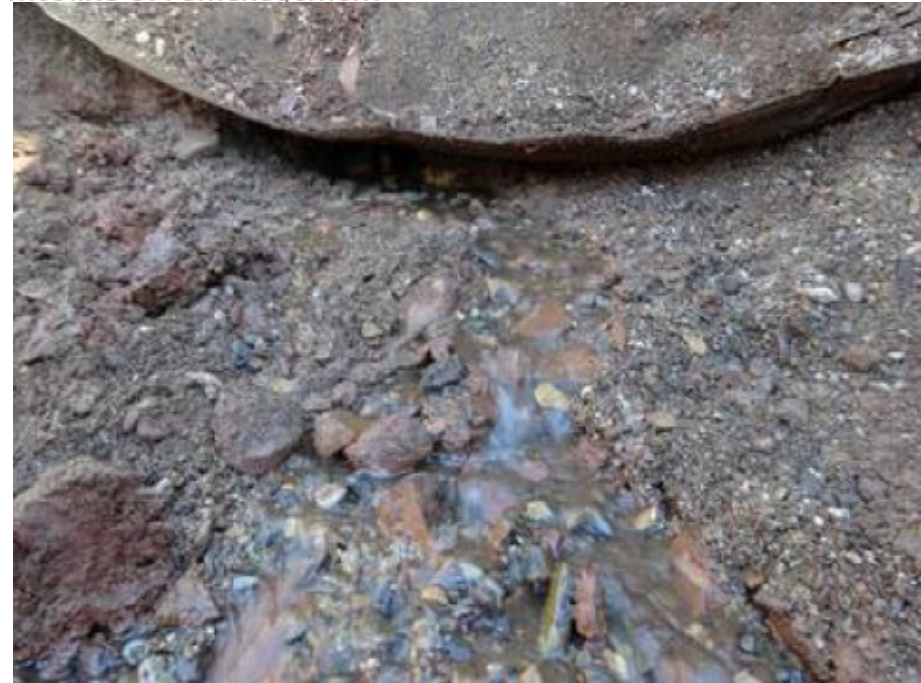
Cavité sous la buse et circulation d'eau à sa base
