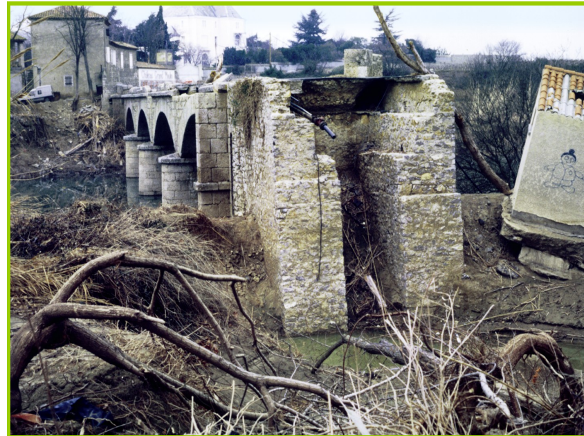
Luc-sur-Orbieu (11) : Remblai du pont détruit pendant la crue de novembre 1999
