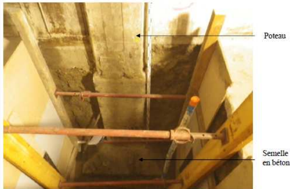
Photo n°9 : reconnaissance Fr A6 - octobre 2011
