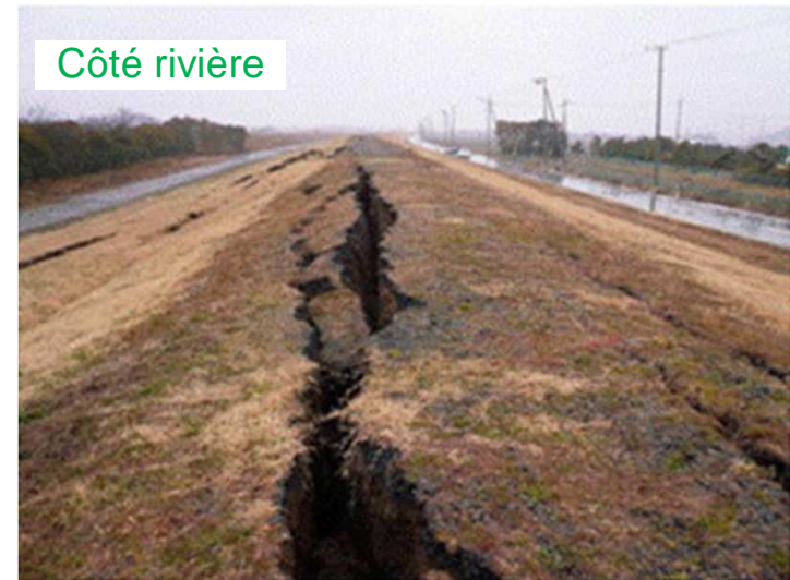
Digue endommagée, rivière Naka, Mitanda, Japon Séisme de Tohoku, 11 mars 2011
