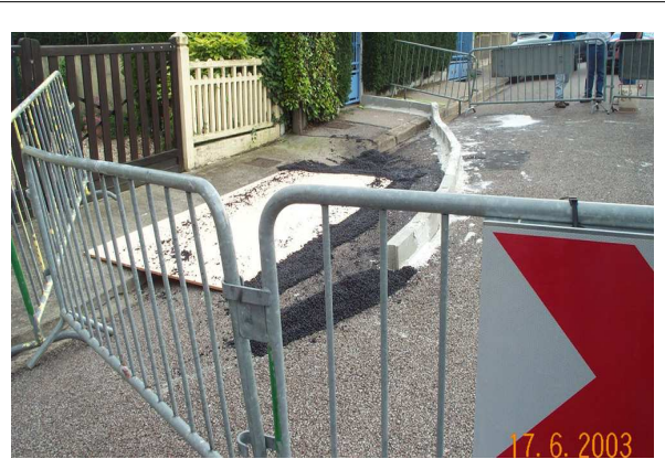
Figure 3 : comblement d'urgence d'un effondrement ayant affecté une voie communale [Cerema, 2003]
