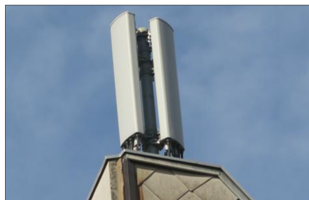
Deux antennes sont installées au-dessus du centre Victor-Hugo.
